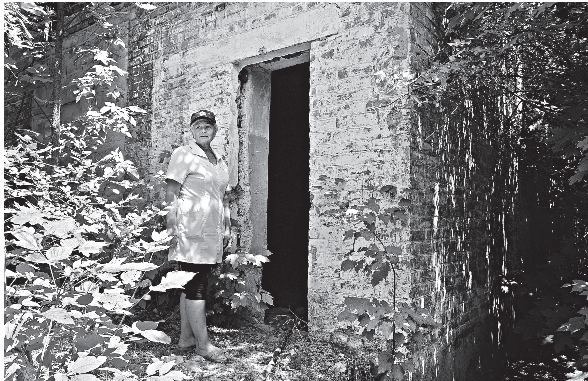
Людмила Збраилова работала нянечкой в детском саду, играла на праздниках Снегурочку, но исполнить заветное желание детей и взрослых посёлка Опорный – отремонтировать здание – увы, невозможно
