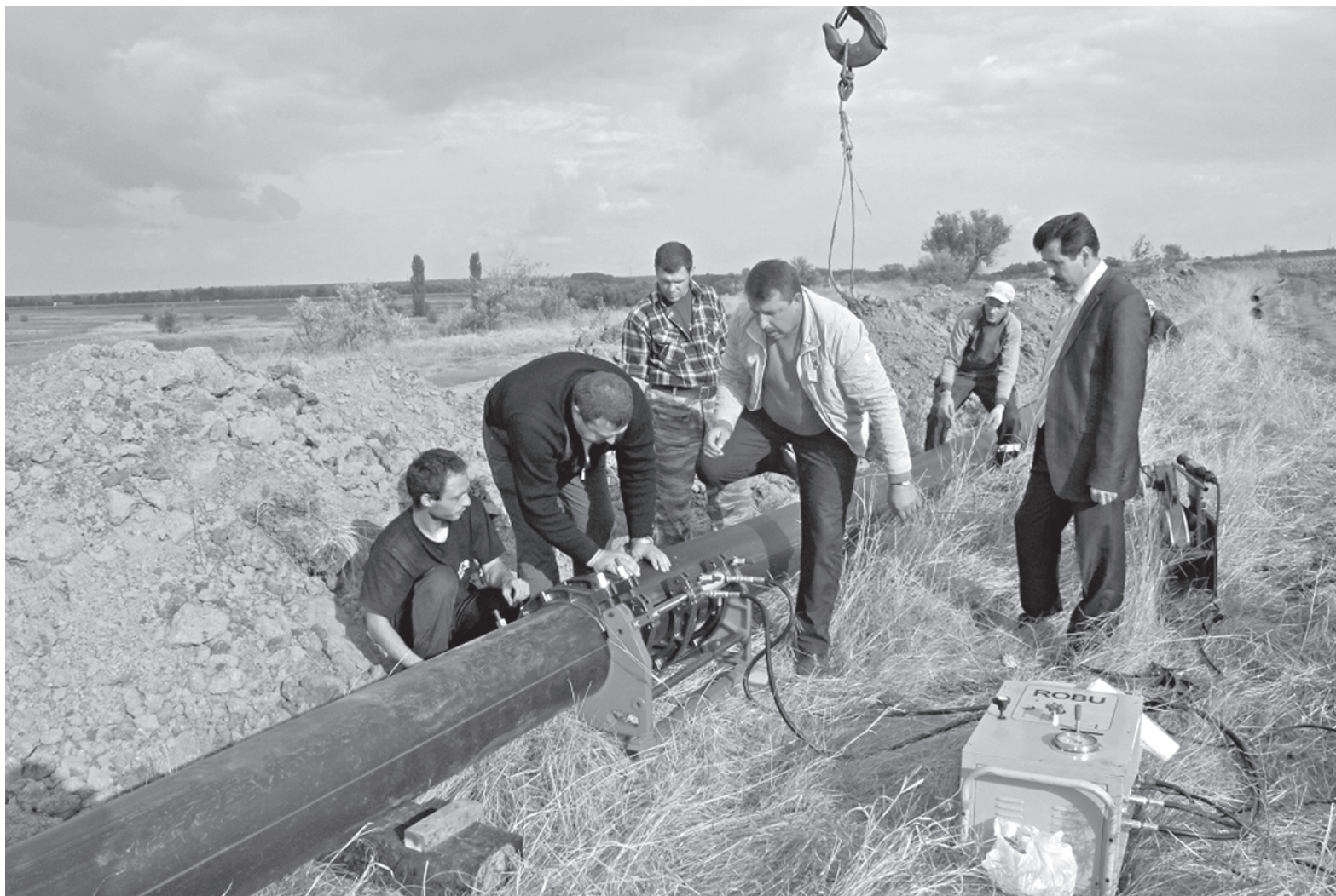
Водопровод «Таловая балка» — М-4 «Дон» — стратегический объект, он снабжает водой три населённых пункта. Трубу заменили в рекордно короткий срок и за рекордно низкую цену. Крайний справа — Алексей Палкин
