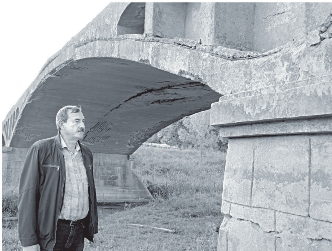
Георгий Сорокин: «Мост не ремонтировали много лет»
