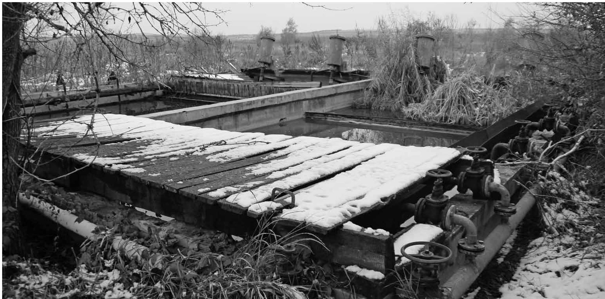
Раньше в очистных сооружениях посёлка Газовиков вода бурлила. Теперь – тихонько журчит, распространяя зловоние
