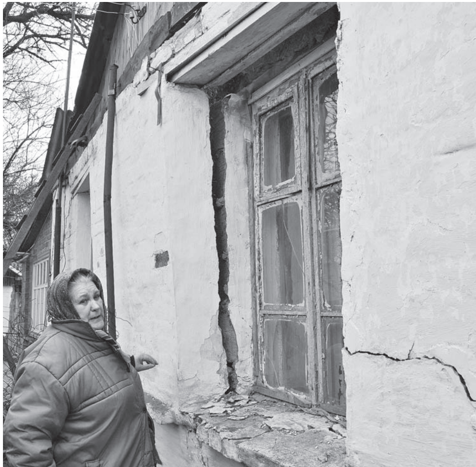
Трещина на доме ярко символизирует разрыв между народом и его слугами
