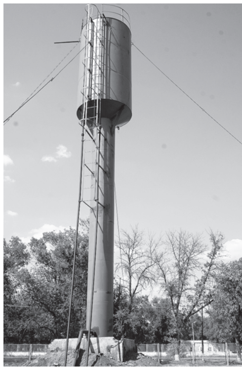
Перекрыть вентиль — и посёлок останется без воды
